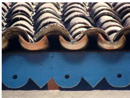
Detalhes de beirais com elementos de madeira, em Pirenópolis, típicos da região Centro-Oeste do Brasil e incomuns na região sul.
