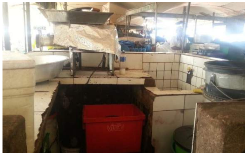
Estado de má conservação dos equipamentos. | Fonte: DPJ, Data: abril, 2015.
