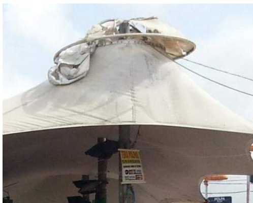
Lona bastante danificada. Fonte: DPJ, Data: Dezembro, 2015.
