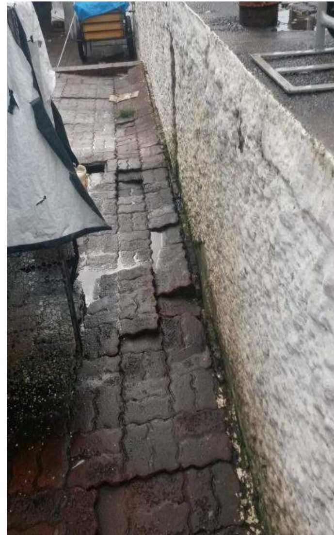
Afundamento do piso. Fonte: DPJ, Data: abril, 2015.
