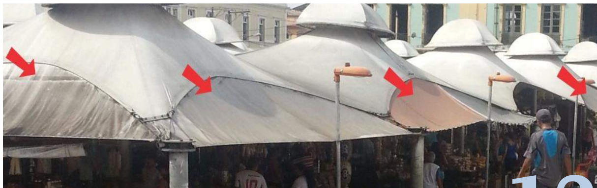
Remendos na cobertura improvisados pelos feirantes. Fonte: DPJ, Data: abril, 2015.
