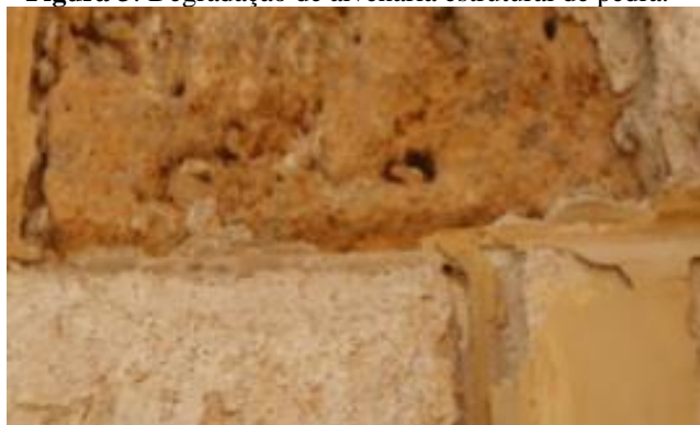
Figura 3: Degradação de alvenaria estrutural de pedra.
