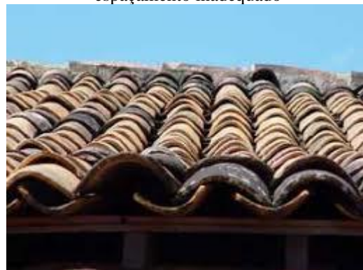
Figura 4: Estrangulamento de telhas devido espaçamento inadequado
