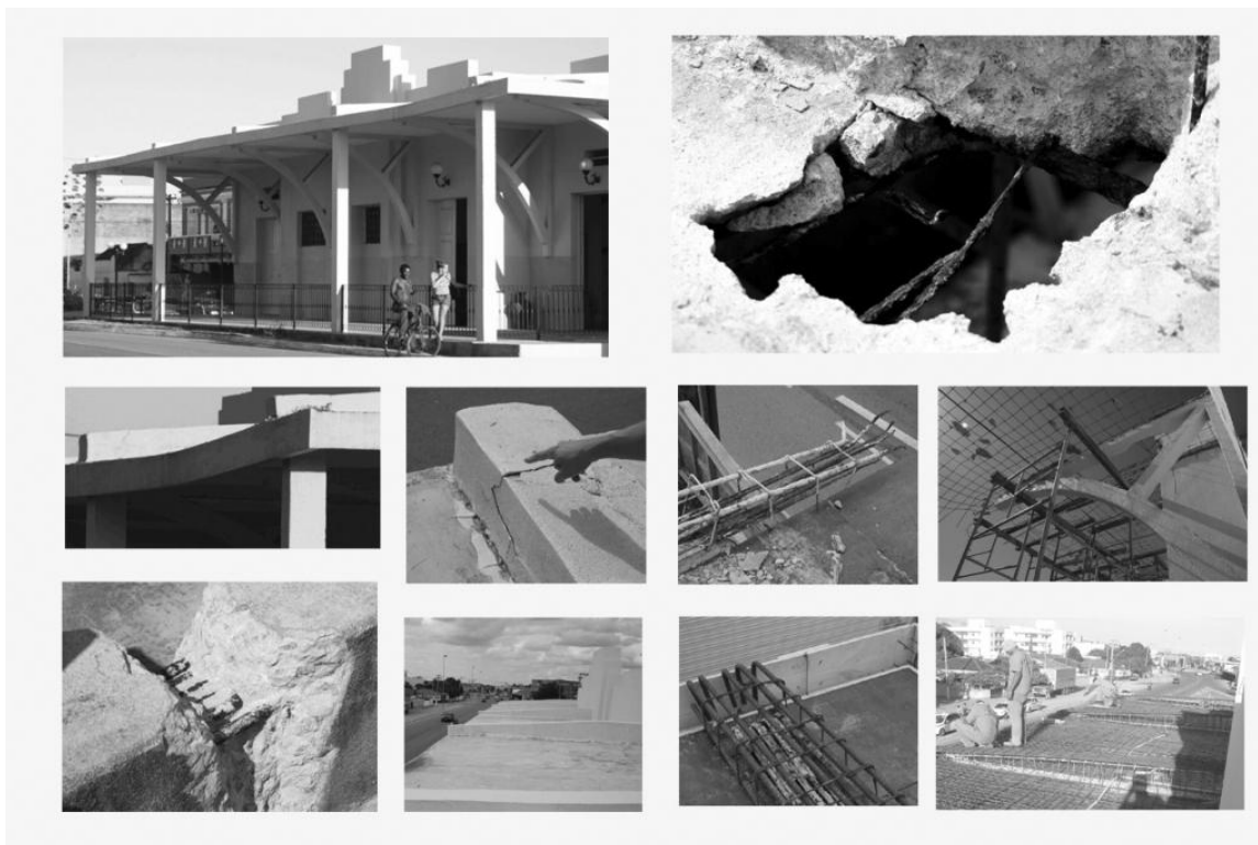
Figura 04: De cima para baixo, esquerda para direita: 1. Estação com pilares de escoras na ponta da marquise e gradil, deturpando a função de plataforma, antes da intervenção. / 2. Estado da ferragem em uma das janelas de inspeção abertas na laje da marquise./ 3. Detalhe de viga de borda e laje fletidas. / 4. Detalhe da ponta da viga invertida, trincada transversalmente./ 5. ferragem deteriorada original desta mesma ponta./ 6. Marquise demolida a parte em concreto, mantida a ferragem original./ 7. Inspeção na base das vigas invertidas: excesso de recobrimento em concreto no negativo./ 8. Conjunto de vigas invertidas, antes da intervenção./ 9. Reforço de ferros para o esforço negativo. Na alma da nova peça a ser consertada, a manutenção da ferragem original./ 9. Armação da execução da marquise.
