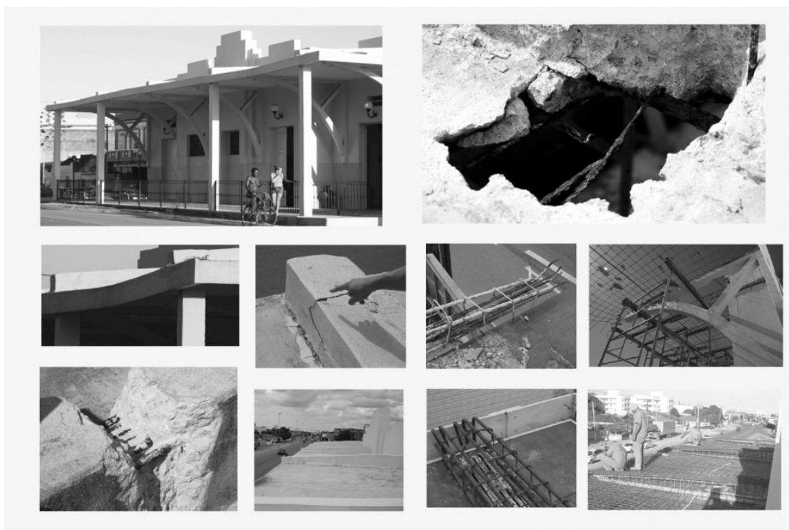
Figura 04: De cima para baixo, esquerda para direita: 1. Estação com pilares de escoras na ponta da marquise e gradil, deturpando a função de plataforma, antes da intervenção. / 2. Estado da ferragem em uma das janelas de inspeção abertas na laje da marquise. / 3. Detalhe de viga de borda e laje fletidas. / 4. Detalhe da ponta da viga invertida, trincada transversalmente. / 5. ferragem deteriorada original desta mesma ponta. / 6. Marquise demolida a parte em concreto, mantida a ferragem original. / 7. Inspeção na base das vigas invertidas: excesso de recobrimento em concreto no negativo. / 8. Conjunto de vigas invertidas, antes da intervenção. / 9. Reforço de ferros para o esforço negativo. Na alma da nova peça a ser consertada, a manutenção da ferragem original. / 9. Armadura da execução da marquise.
