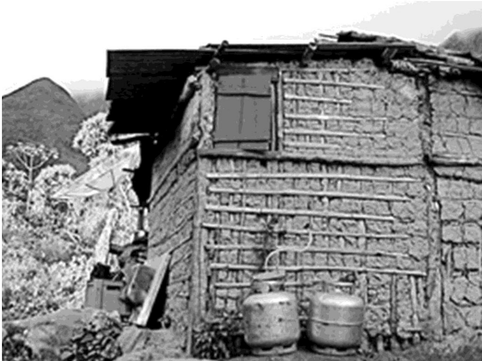
Figura 4. Uma das precárias construções que vêm sendo feitas no Meio da Serra, interferindo na paisagem local. Acervo pessoal. Foto obtida ao longo das pesquisas.
