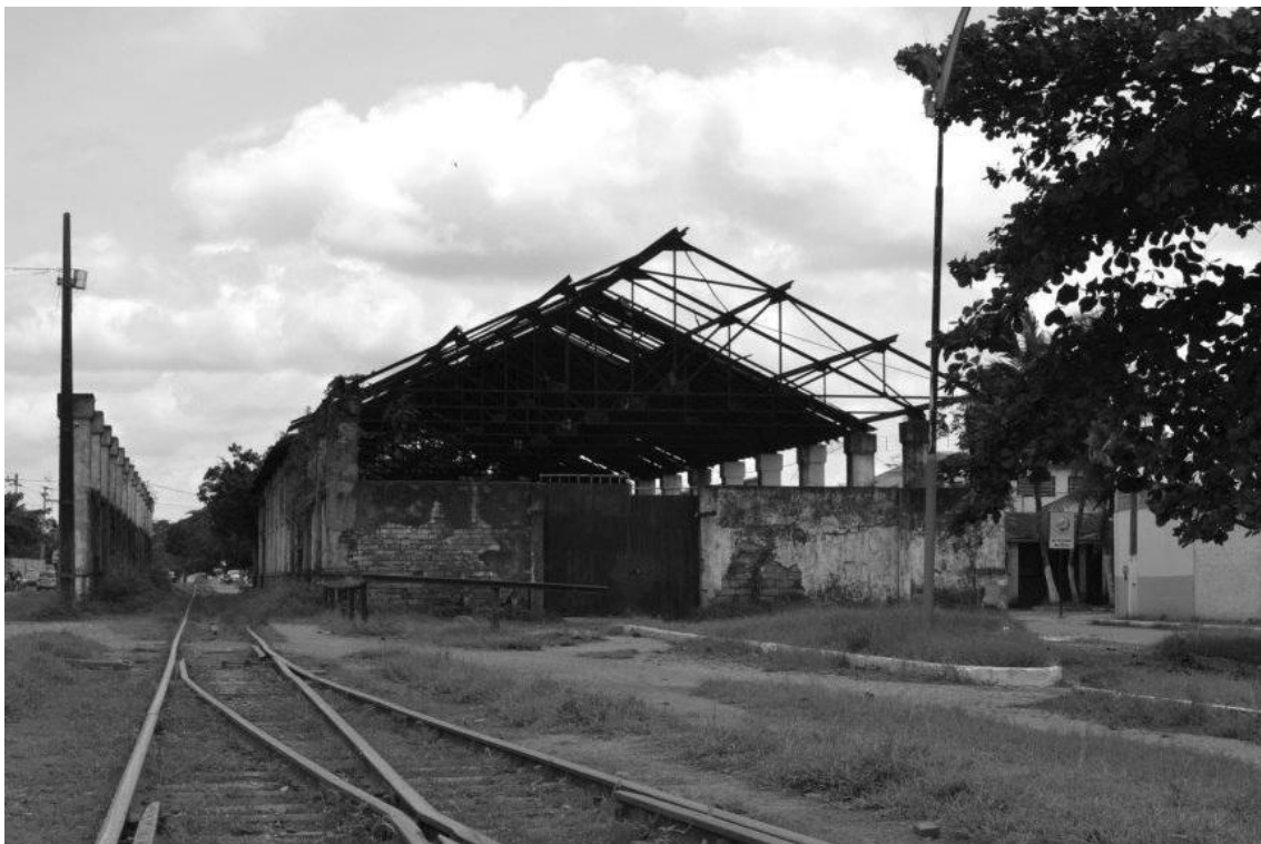
IMAGEM 04 – Um dos dois galpões de reparos de composições da Estação de Rosário (o outro perdeu o telhado, e mantém apenas as colunas que formavam as paredes laterais, parcialmente visíveis à esquerda da imagem). Rosário, Maranhão, 04/2012 (Foto do autor).
