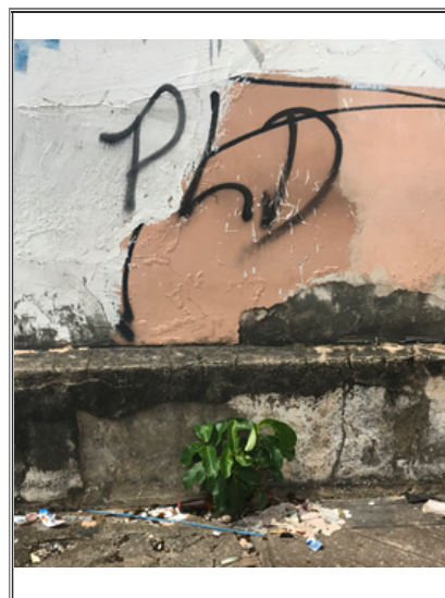
Figura 2: Embasamento das alvenarias da fachada, apresentando argamassa cimentícias, destacamento e descontinuidade de pintura e pichações.
