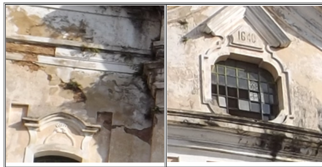
5 – Perda de reboco, destacamento de pintura e fissuras na fachada lateral da Igreja de Nossa Senhora das Mercês e danos em esquadrias e outras vedações, com lacunas de vidros e estruturas em madeira.
