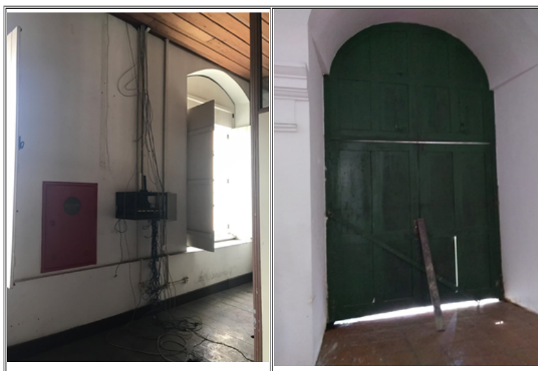
Figura 7: Ambiente internos no Convento dos Mercedários, onde observam-se problemas nas instalações prediais e segurança em portas e janelas.
