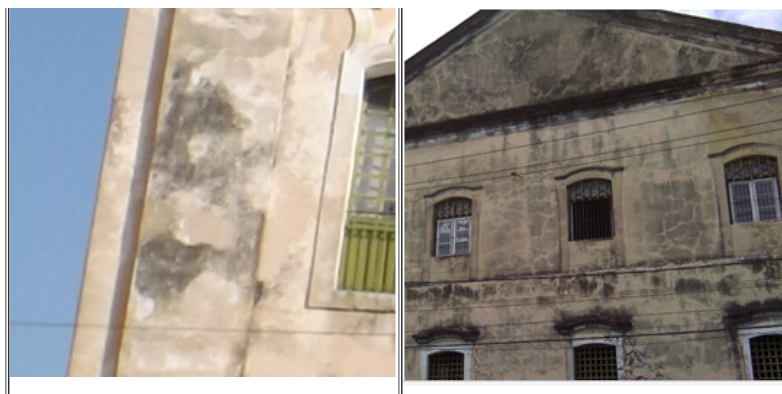
Figura 6: acúmulo de sujidades e manchas na fachada principal e posterior da Igreja de Nossa Senhora das Mercês
